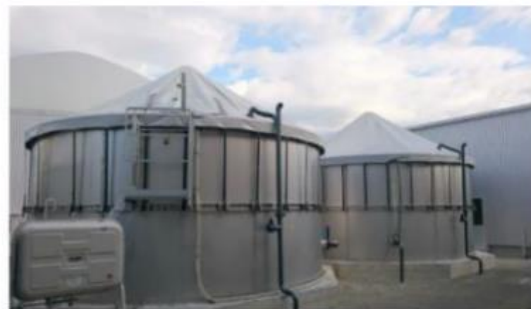
バイオガス発電 中野市
